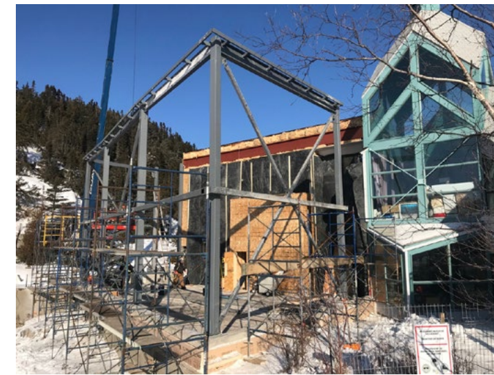
La structure de métal permet de visualiser le volume que permet l'agrandissement de la salle d'exposition.
